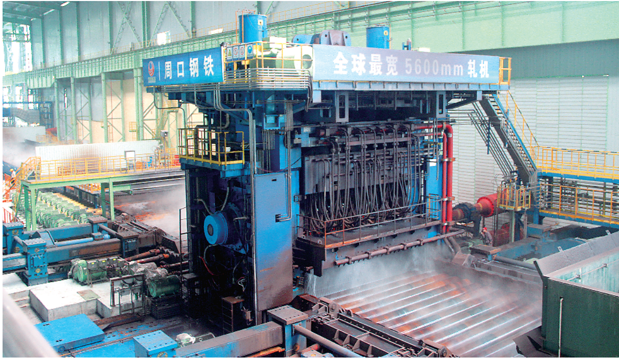
周口钢铁有限责任公司的宽厚板生产线。
